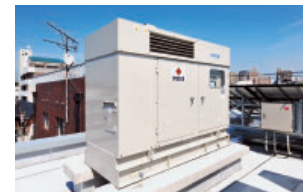
非常用発電装置（みどり台支店）
