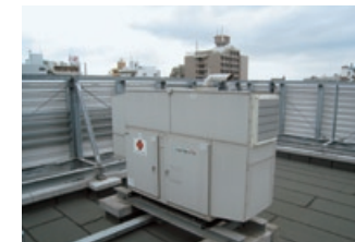
非常用発電装置（蘇我支店）
